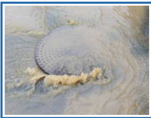
Lösung: illegale Fremdwassereinleitung.
