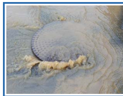
Lösung: illegale Fremdwassereinleitung
